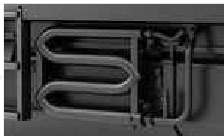
Freistehende Kühlschlangen am Tank
