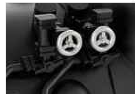
Freistehende und aufwendig umgesetzte Leitungen am gesamten Kessel
