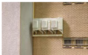
HO 13619 Klimaanlagen 6 Stück insgesamt, pro Bauart 2 Stück
